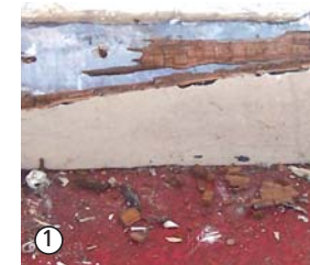
L'eau accumulée derrière la peinture a permis le développement d'un champignon de pourriture.
